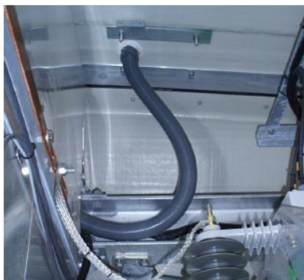
Detalle del tubo flexible en el interior del recinto del transformador por el que pasa el cableado de los sensores ambientales.
