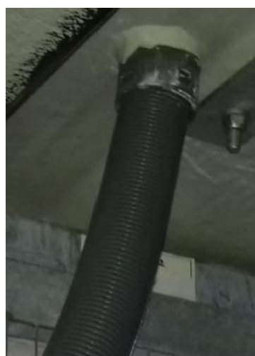
Detalle de la sujeción superior del tubo flexible en el interior del recinto del transformador.
