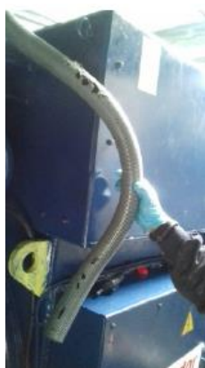
Detalle de las zonas del tubo flexible agujereadas probablemente por estar en contacto con la guía metálica.
